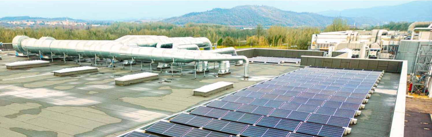
Pannelli fotovoltaici per autoconsumo linea produttiva
