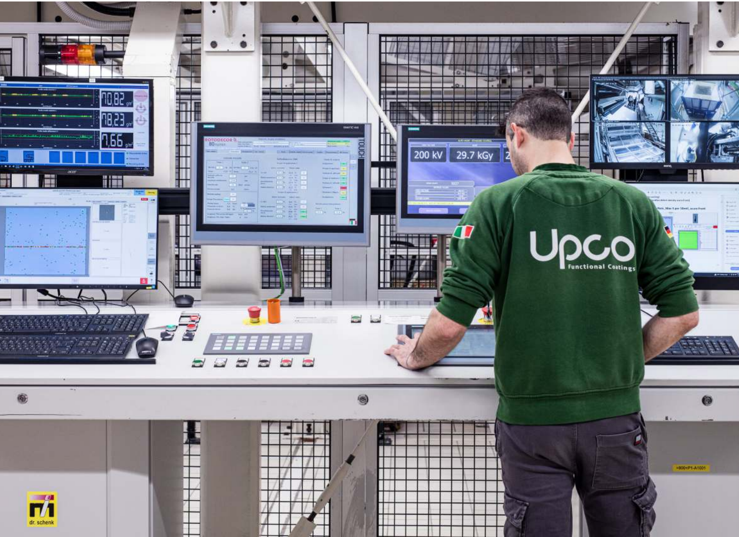
Pannello di controllo linea Upco
