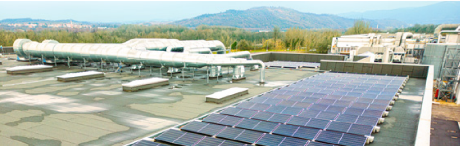
Pannelli fotovoltaici per autoconsumo linea produttiva
